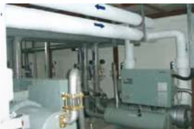
Strojovňa konvenčného tepelného čerpadla s vodným zdrojom.
